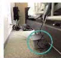
ベッド下BOX (ルーター+スマートハブ)
